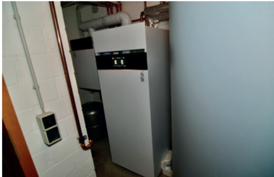
Bild 4: Das Bestands-Einfamilienhaus wird mit einer Brennstoffzelle beheizt, die auch Strom erzeugt
