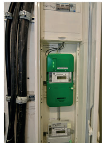
Bild 8: Discovery Smart Meter erfassen alle Strombewegungen im Haus
