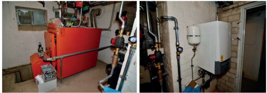
Bild 9: Die rund 30 Jahre alte Gasheizung wird demnächst durch ein Remeha-Blockheizkraftwerk ersetzt, ein Remeha Spitzenlastkessel mit 60 kW ist bereits montiert
