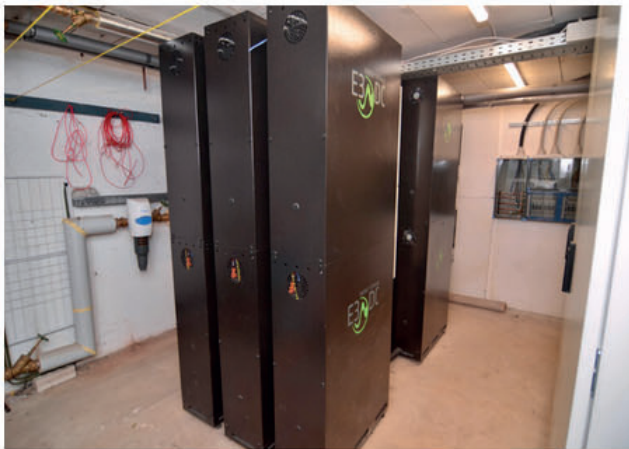
Bild 7: Die Türme mit den Quattroporte-Speichern von E3/DC arbeiten im Farming-Betrieb und haben eine kumulierte Kapazität von 156 kWh
