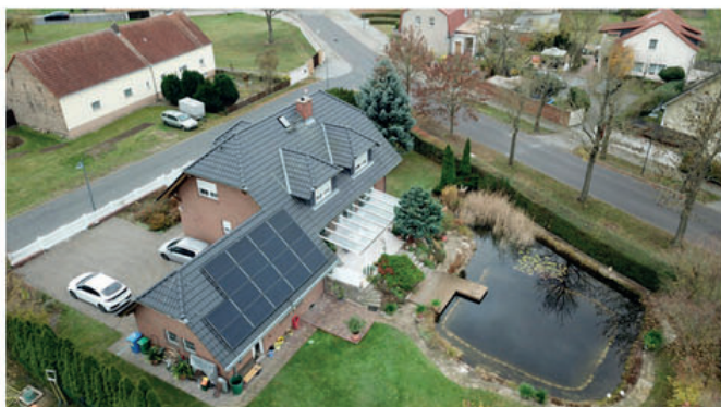
Bild 2: Das Bestandsgebäude der Baufamilie wurde mit Aleo PV-Elementen in Ost-West-Ausrichtung ausgestattet
